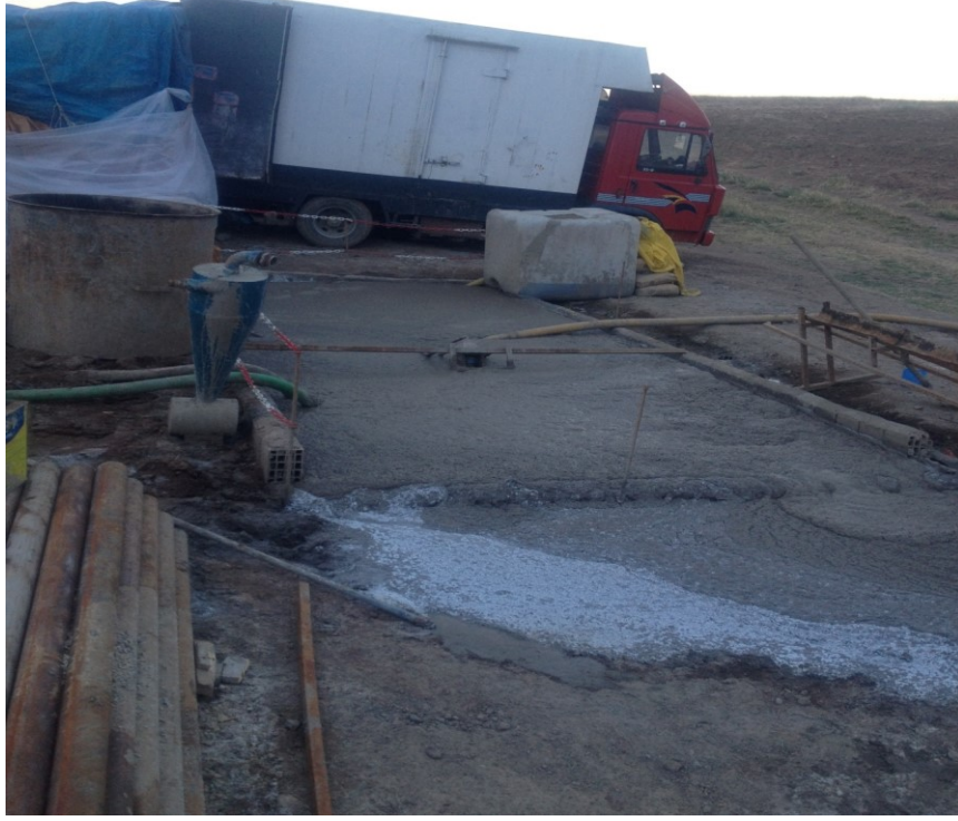
Şekil 13. Çamur havuzlarında çamurun bozuşmuş hali
